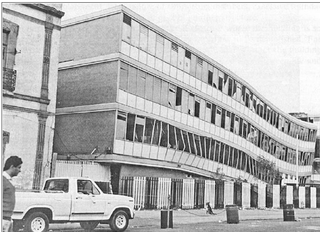
Figur 2.10 Den nærmeste enden er avstivet av stive skjærvegger, mens den andre enden var avstivet av slanke søyler. Den resulterende torsjonsbevegelsen førte til kollaps i Mexico City, 1985. [12]
