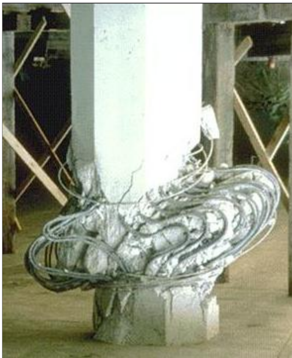
Figur 2.5 Oppsprekking av søyle under motorveg i Northridge, California, 1994. [24]
