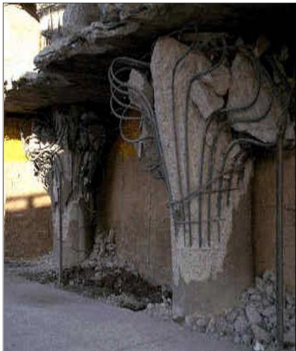
Figur 2.6 Oppsprekking av søyler under motorveg i Northridge, California, 1994. [24]
