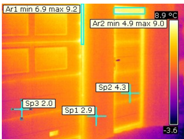
Illustrasjon 22: Utvendig varmefotografi av ytterdør i verkstaden
