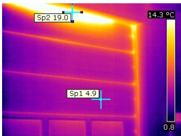
Illustrasjon 24: Utvendig varmefotografi av verkstadport
