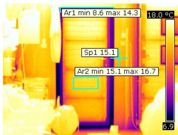
Illustrasjon 23: Innvendig varmefotografi av ytterdør i verkstaden
