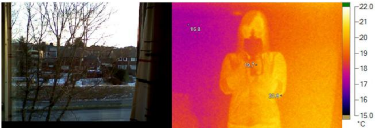
Figur 6. Betydningen av reflektert stråling. Bildet til venstre viser vinduet slik øyet ser det, mens varmebildet til høyre viser min egen refleksjon i ruten
