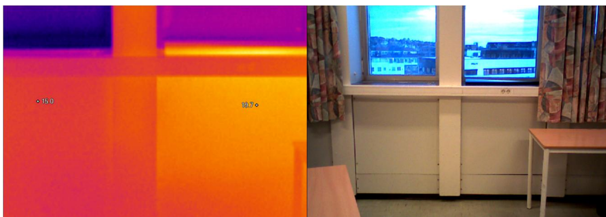
Figur 12. Varmebilde av innvendig vegg i hovedbyggets 4. etasje. QVB - apparatet under vinduet til venstre er i ustand, hvilket fører til en kaldere vegg- og vindusflate. De to punktene markerer en temperaturforskjell på 4,7 °C på de to veggplatene.
