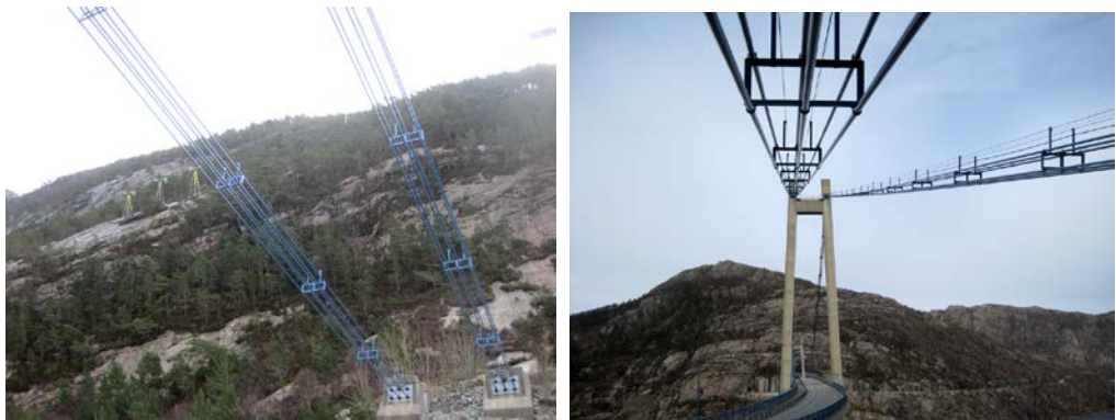
Figur 2-9: Hovedkablene i sidespennene spredt i to lag med tre kabler i hvert. Sett mot ankerfestene på Forsand-siden (sørsiden). (Gran, 2012)
