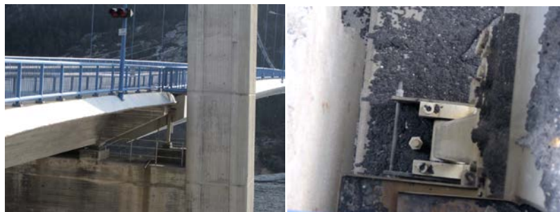
Figur 2-6: Bildene over viser opplagrene i nord-enden, altså på Oanes-siden. Her er brobjelken fri i lengderetningen. (Gran, 2012)
