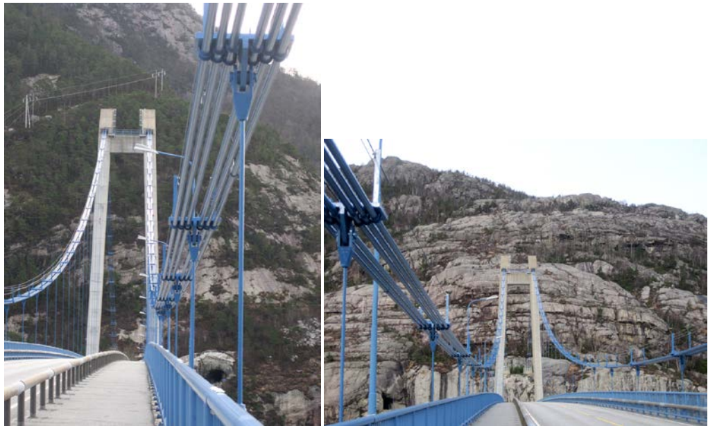
Figur 2-8: Hovedkablene i hovedspennet ligger parallelt i ett lag med seks kabler. (Gran, 2012)
