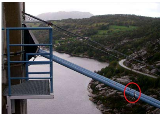
Figur 3-5: 1 sensor per kabel ved tårnene på sidespenn-siden, til sammen 24 stk. (16)
