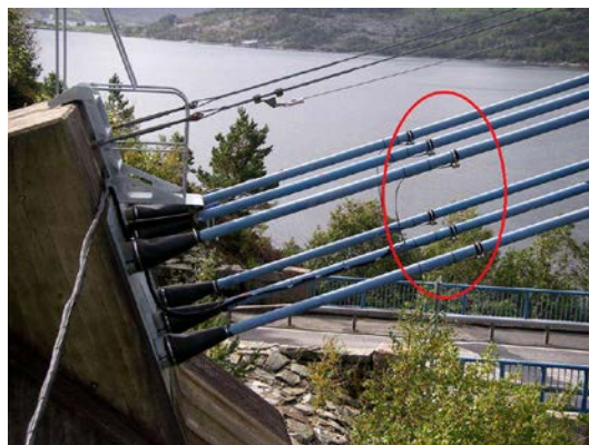
Figur 3-4: 1 sensor per kabel ved hvert anker, til sammen 24 stk. (16)
