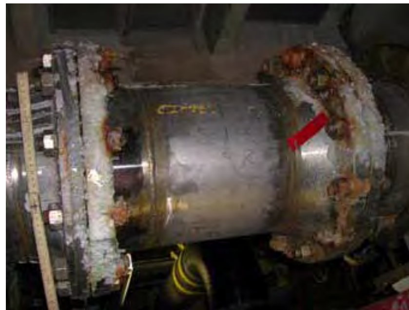
Saltavleiringer på rustfritt stål
