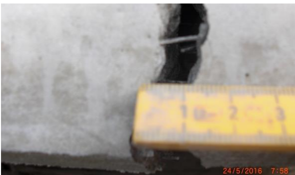
Vedleggsbilete 14 – Dei fiberarmerte sjikta fekk svært store riss då all heft mellom fiber og betong forsvann
