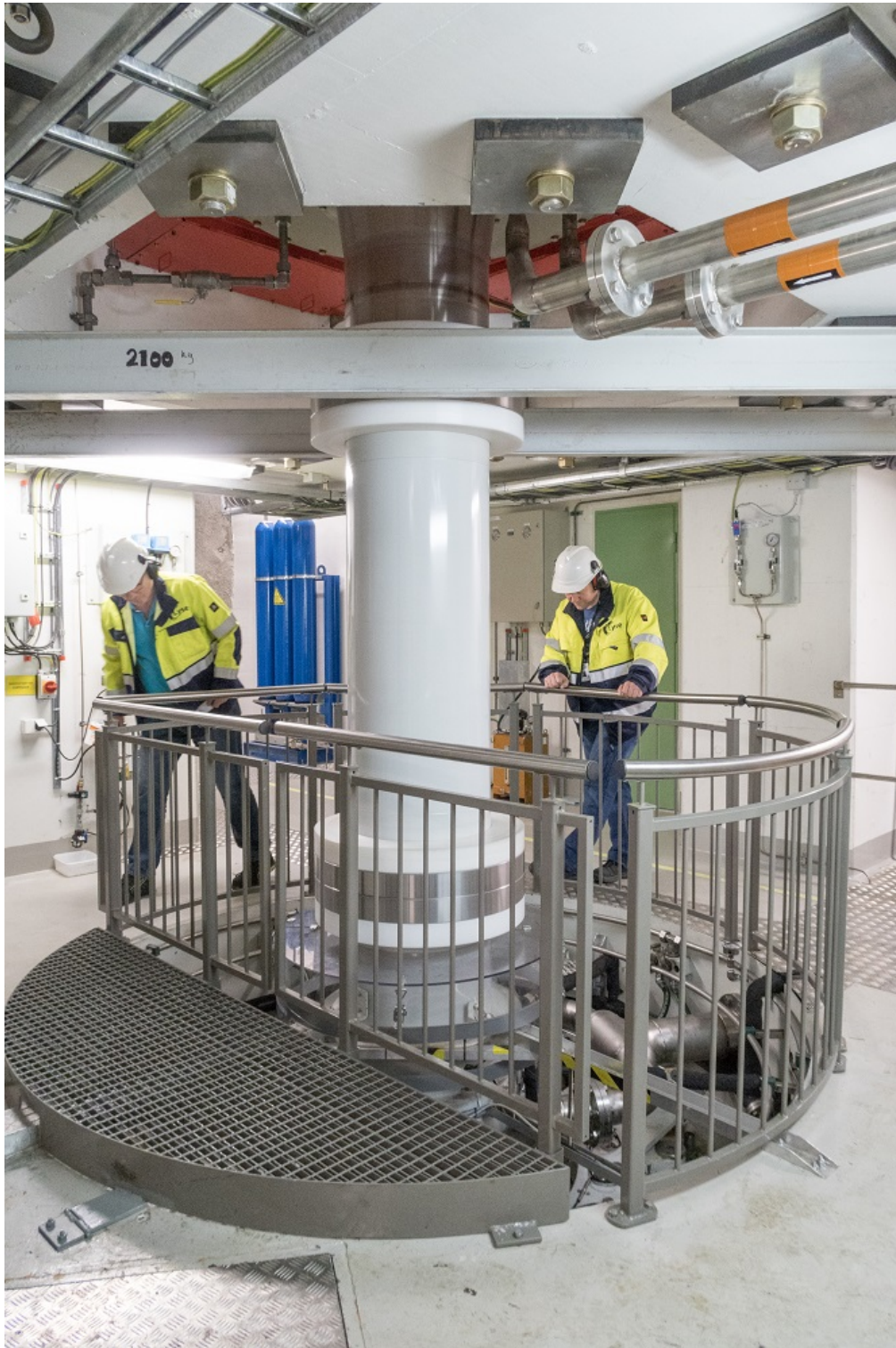
Figur 4.2: Bilde av aksling mellom turbin i bunn og generator i toppen ved Jøssang
