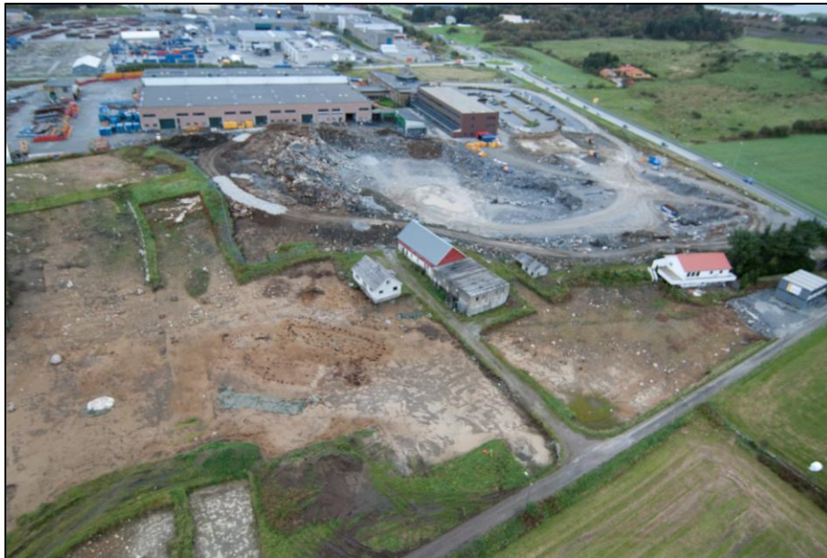
Figur 7: Id.114908 etter utgravning. Gravfeltet id.14854 er her fjernet. Tatt mot NØ. Foto: E. Torp/ «Birdy».
