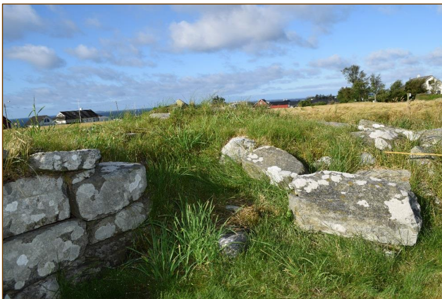
Figur 16: Indrevangen, sørvesthjørnet, før arbeidet begynte. Torvlaget i morkjernen hadde vokst sammen med torvlaget i kirkerommet og dermed dekket til utraste steiner og det nedre skiftet av murlivet.
