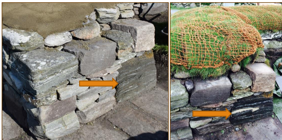
Figur 36(a) og (b): Sprekkene før og etter behandlingen.
