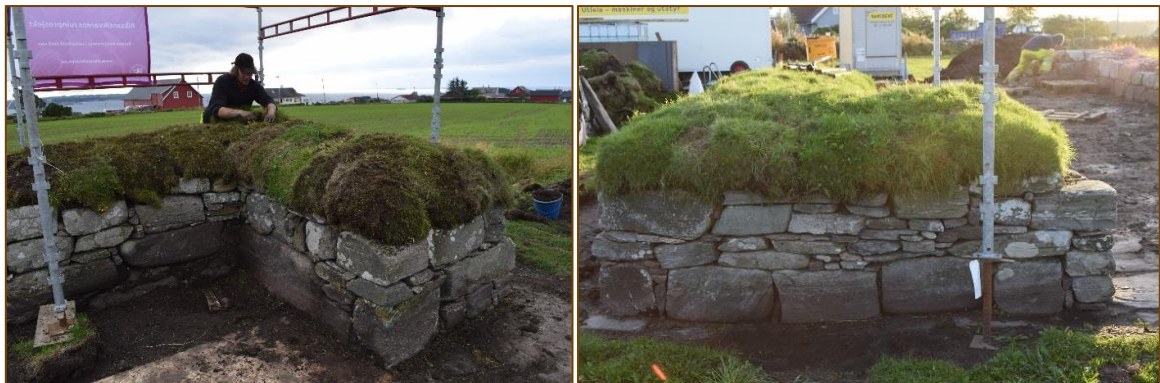
Figur 32(a): sørvestre hjørnet, legging av torvlaget (b): nordre delen av vestveggen, lagt ferdig torvlaget.
