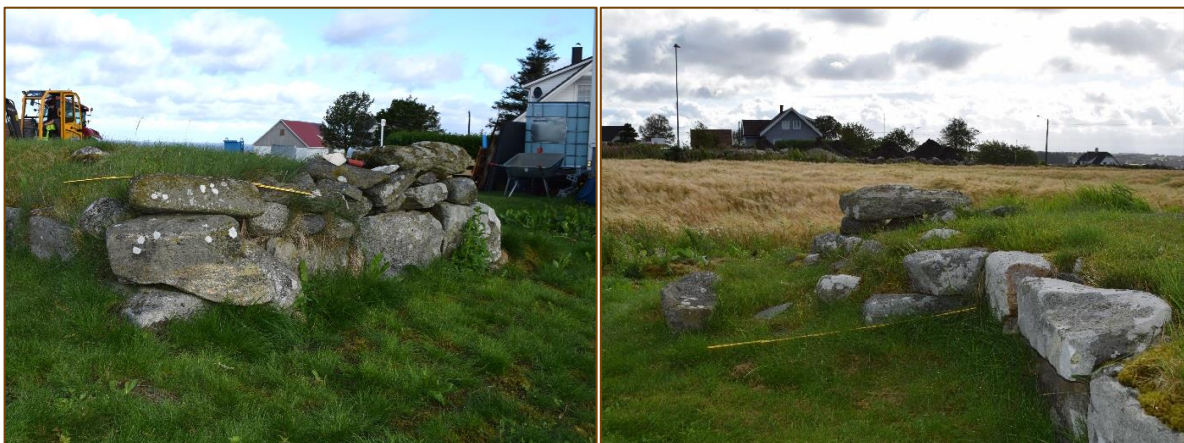
Figur 9(a): Ytrevangen av østveggen, sett fra sørøst. Ustabil murverk står i fare for ytterligere kollaps, og steinene passer ikke til formen på hjørnet (b): Vangen inn mot kirkerommet, på bildet ble tatt mot øst. Murverket er gjemt av gress.
