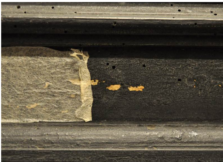
Figur 21: Opp- og avskallinger langs nedre rammelist, samt flere av borebillehullene som er dekket av sekundær sort maling.
