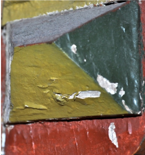
Fig. 21: Opp- og avskallet maling på diamantkloss under søylen til venstre for Johannesfeltet på galleribrystningen.
