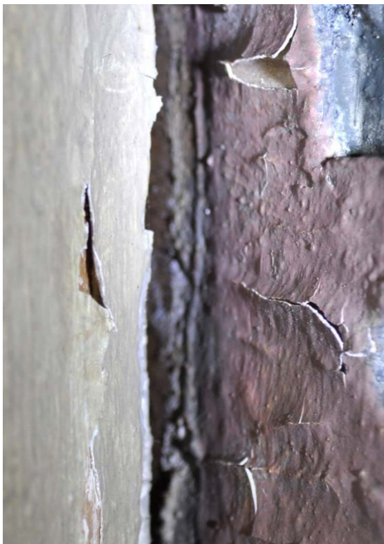
Fig. 19: Detaljer av oppskallet maling på rammeverk på prekestolen.
