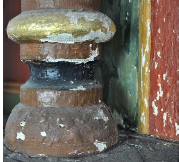
Fig. 22: Opp- og avskallet maling på base til søyle til venstre for Judas Taddeus-feltet på galleribrystningen.
