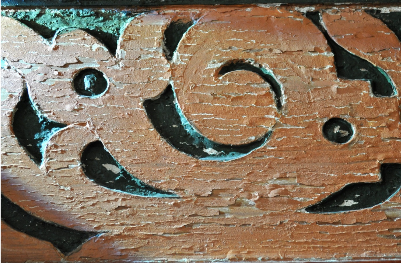
Fig. 25: Opp- og avskallet maling bjelkefeltet over Thomas på galleribrystningen.
