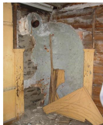
Fig. 16. Nordvestre hjørne med brannmursnisje. Utfall av puss. Foto 2012.
