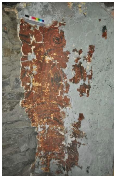
Fig. 63. Avdekket flate av lag på brannmur. Venstre del av brannmuren er borte, midtre del er avdekking er i dårlig tilstand og høyre del består av sekundær puss.
