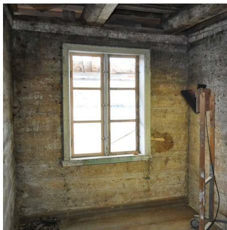
Fig. 18. Østvegg. Himlingsbord og veggpapp fjernet. Huggespor i tømmerets overflate for tidligere påført puss. Foto 2012
