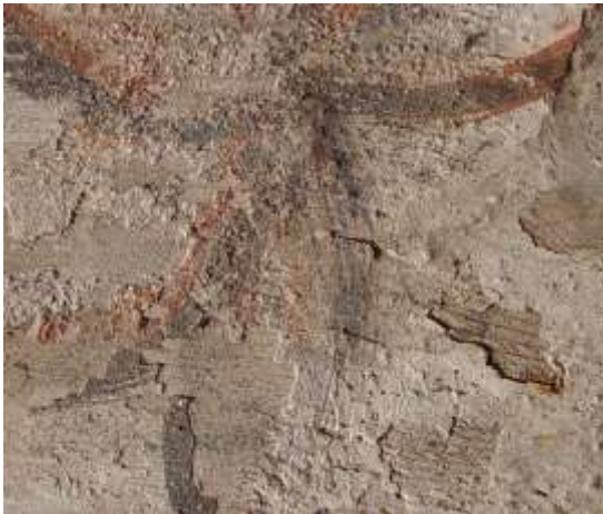
Fig. 11: Detalj av oppskallet maling på bord 4 felt B.
