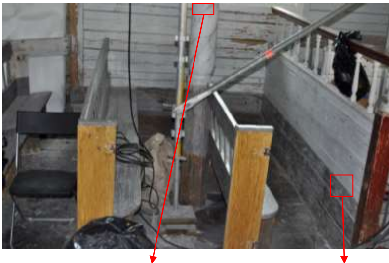
Fig.14. Nordøstre del av skipet etter at malerne har fjernet maling på benkene og veggene. Original mørk lilla farge på benker og nedre del av vegg står fremme (lag 1 på B).
