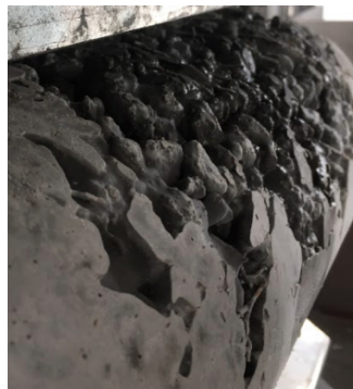
Figur 31 - Betongen fyller ikke ut formen
