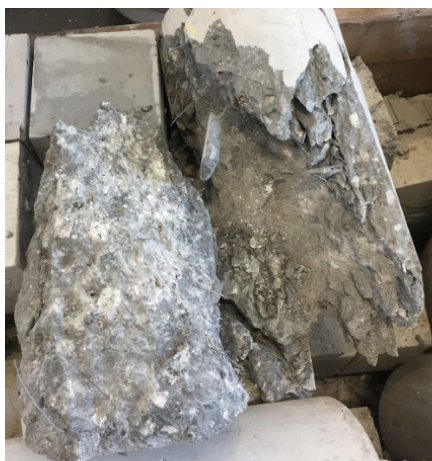
Figur 68 - Dårlig fordeling av fiber
