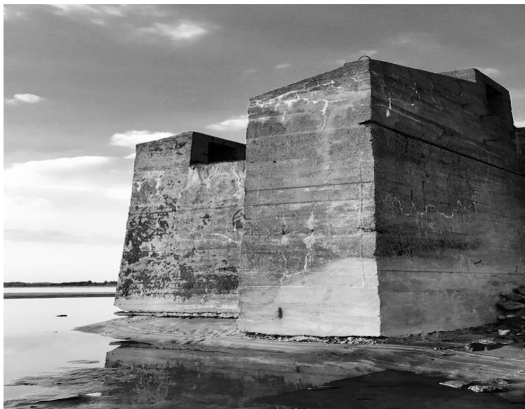
Figur 14 Når overbygning mangler kobling til fundamentet
