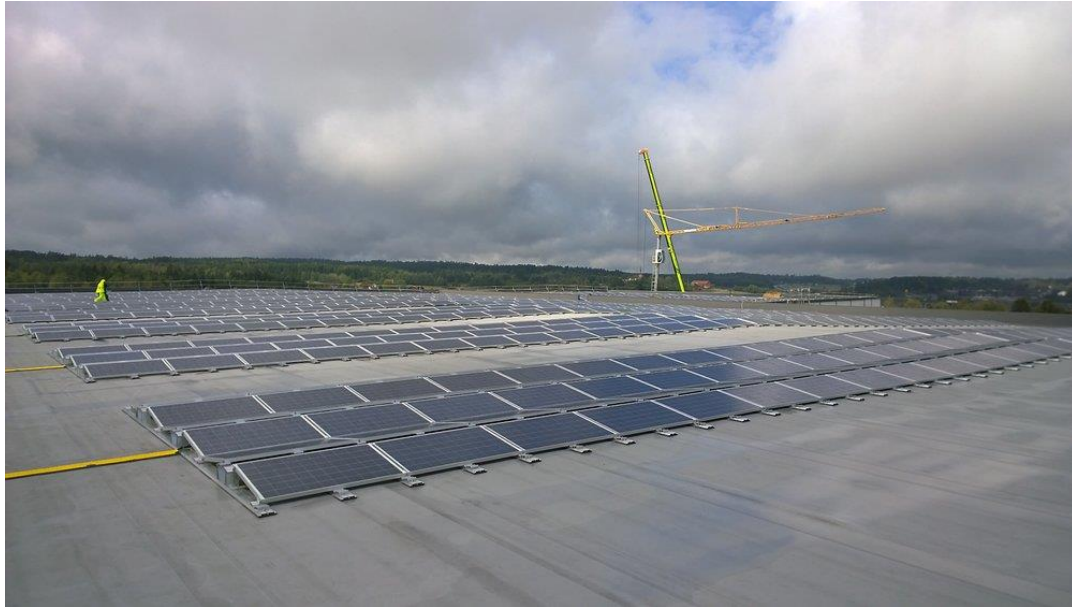
Figur 7 Solceller på taket til lagerbygning
