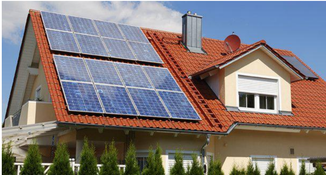
Figur 5 Komplet solcelleanlegg (4,2 kWp)
