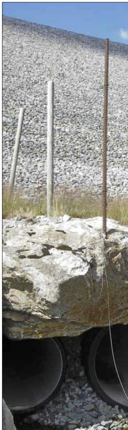
Leakage from Svartevassdammen. (illustrasjonsbilde)
