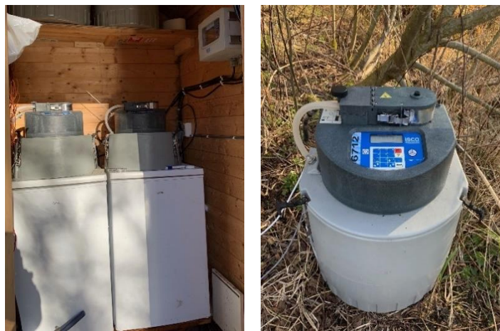
Figur 9: a) Viser ISCO 6712 i målehytten. b) Viser den samme type prøvetakeren ved innløpet.
