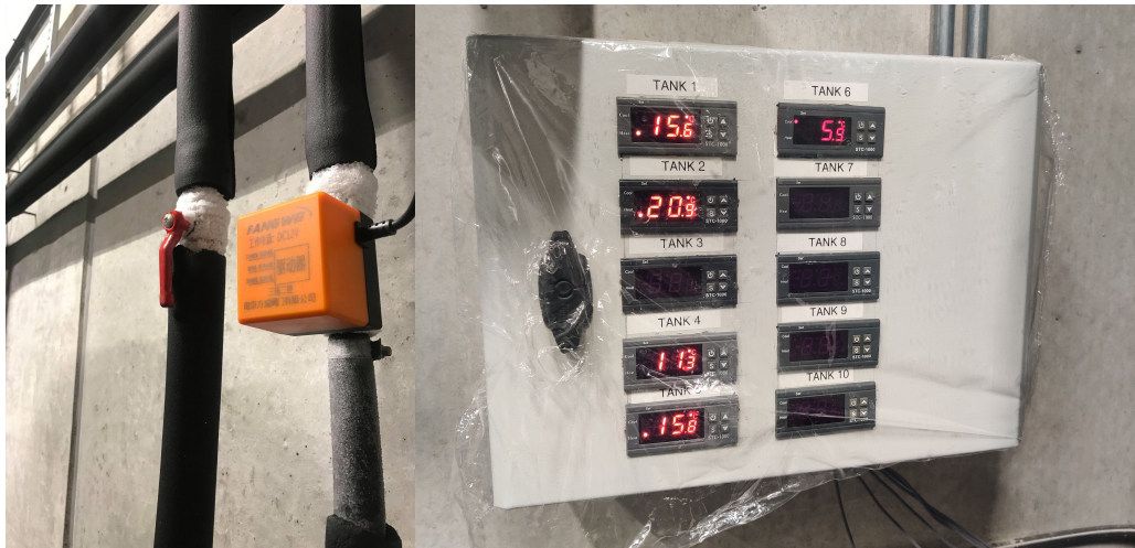
Figur 1.4: Eksisterende ventiler og styreskap for gjæringsprosessen. STC100-enhetene er felt inn i døra.
