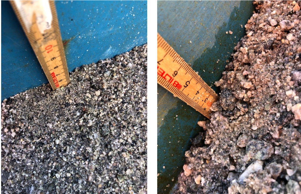
Figur 121: Målinger ved øvre og nedre del av dekke.
