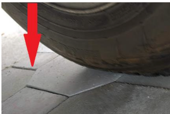
Figur 43: Liten forskyvning i S01-dekket.
