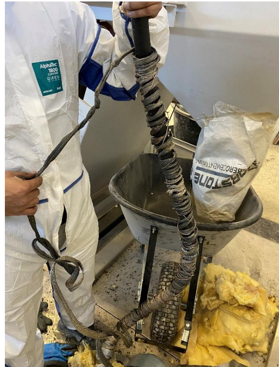
Figur 14: Fleksibel varmeslange surret rundt med varmekabel
