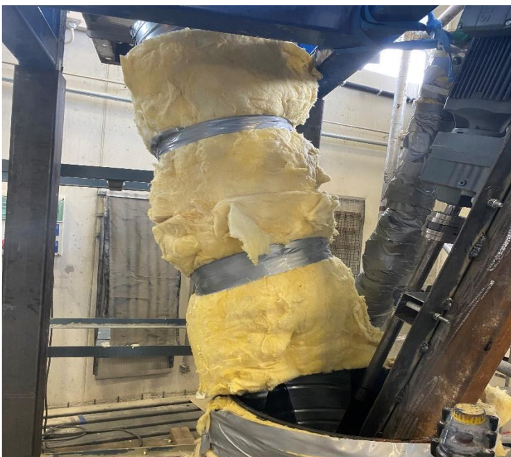
Figur 18: Bitumenrenner isolert med isolasjon som vil føre restbitumen fra siktemaskin tilbake til fatet
