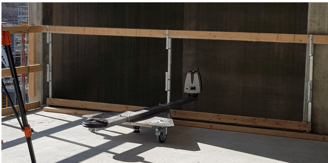
Figur 4.7.: Leica skanner koblet til et horisontalt type stativ for å skanne heissjakt. Bilde tatt fra Nye SUS prosjektet i Stavanger.
