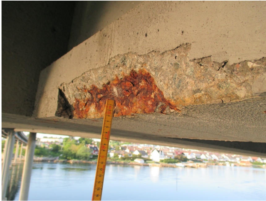
Figur 57: Korrosjon på nederste spenntaulag i akse 2 [9, s. 11]
