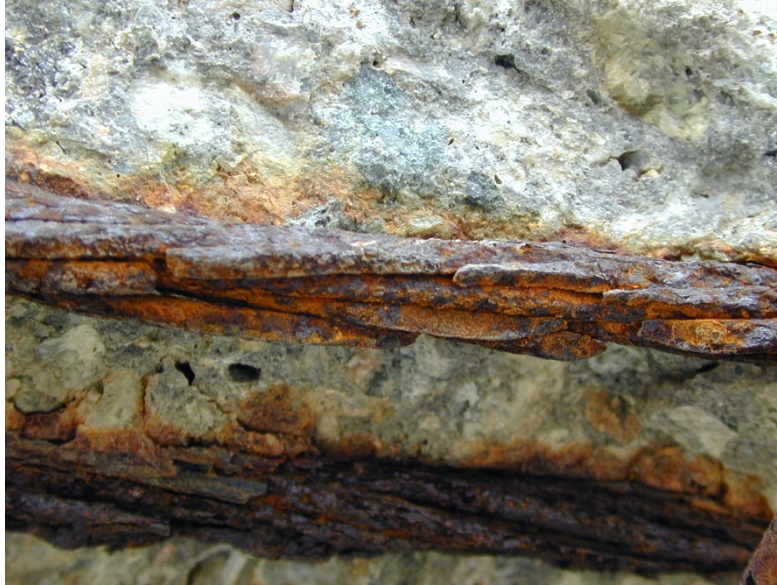
Figur 60: Spenntråder har røket på grunn av korrosjon på spenntau [18, 6/9 2001]
