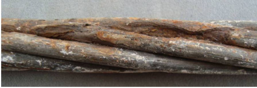
Figur 30: Korrosjon i forbindelse med oppsmuldret mørtel [49]
