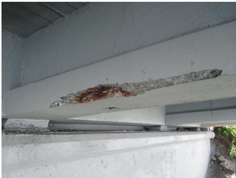
Figur 58: Korrosjon på bjelke inn mot landkar, Akse 11 [9, Vedlegg 3 s. 13]
