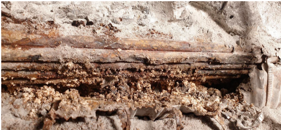
Figur 29: Eksempel på kabelrør med korrosjon i forbindelse med oppsmuldring av mørtel [49]
