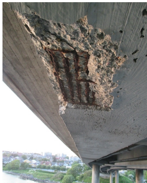
Figur 56: Korrosjon på nederste spenntaulag på vestre bjelke i hovedspenn [9, s.11]
