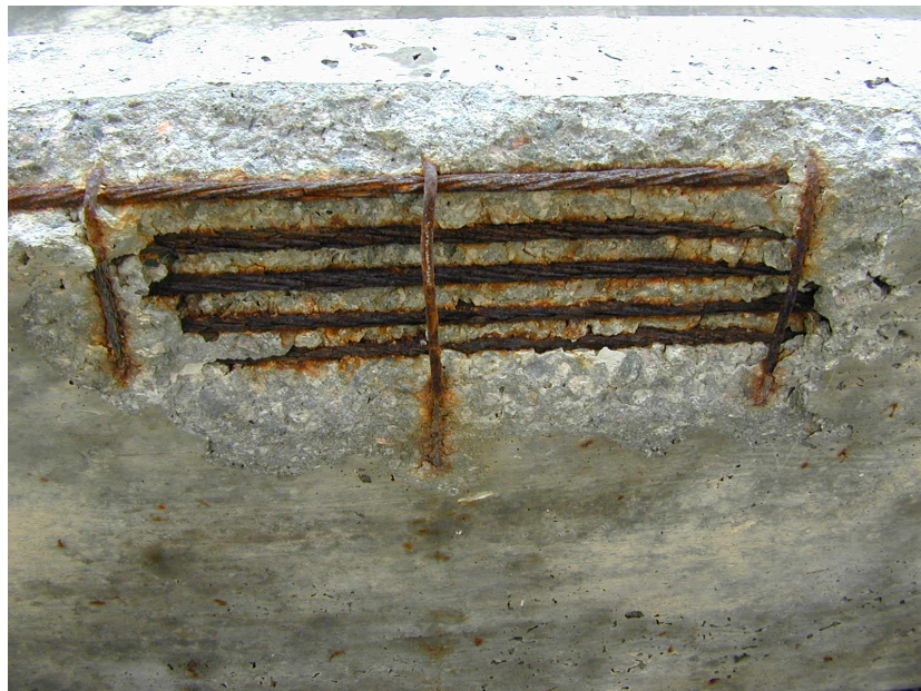
Figur 59: Korrosjon på nederste spenntaulag og bøylearmering [18, 6/9 2001]
