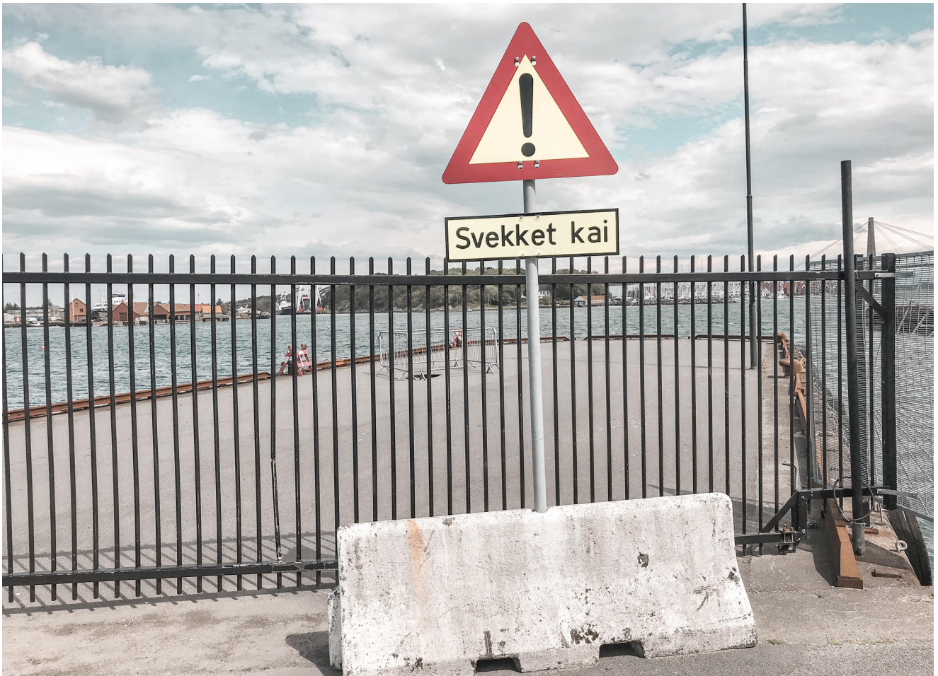
Figur 3.69: Utstikkeren på Holmen er stengt av og er en svekket kai
