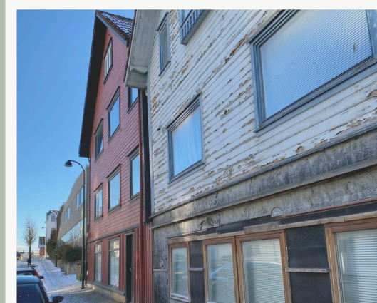
Figur 76- Flere av trehusene er preget av slitasje.
