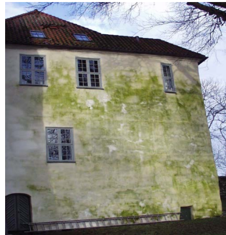
Figur 19: Biologisk vekst på betongoverflate [23]
