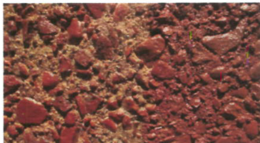
Påverkan av järnklorid på betong i vattenreningsanläggningar
