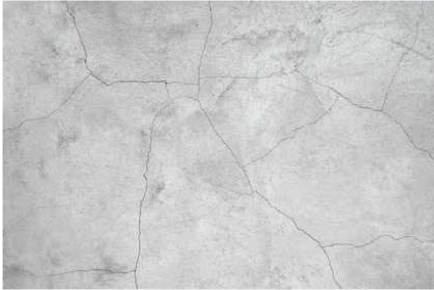
Figur 18 – Sprekker som følge av svinn
