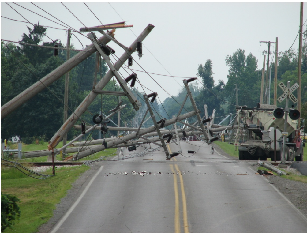
Figur 40 – Skade som følge av ekstrem vind
