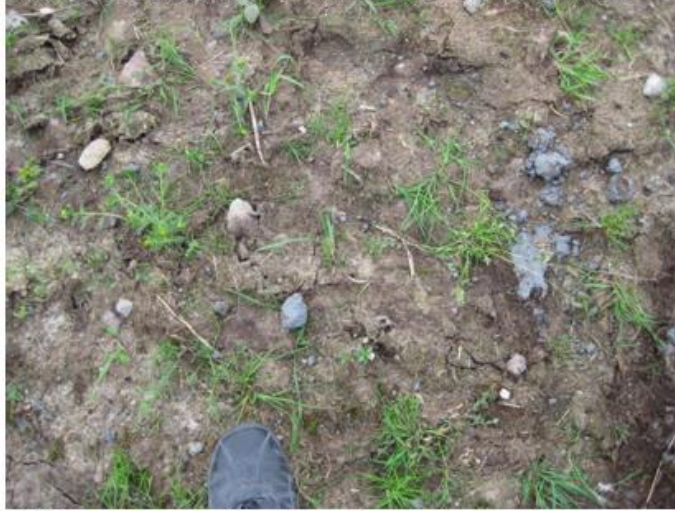
Relativt store klumper av betongslam og stor avstand mellom disse
