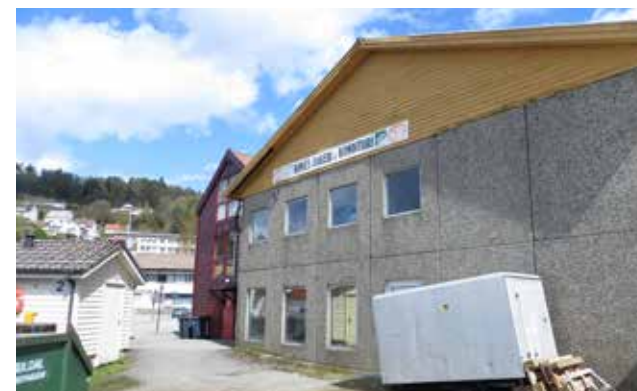
Figur 4.21 Det tidligere bakeriet Rones står i dag tomt. Bygningen er både nedslitt og mindre estetisk tiltalende til tross for svært sentral og sjønær beliggenhet (K. Hjorteland)
