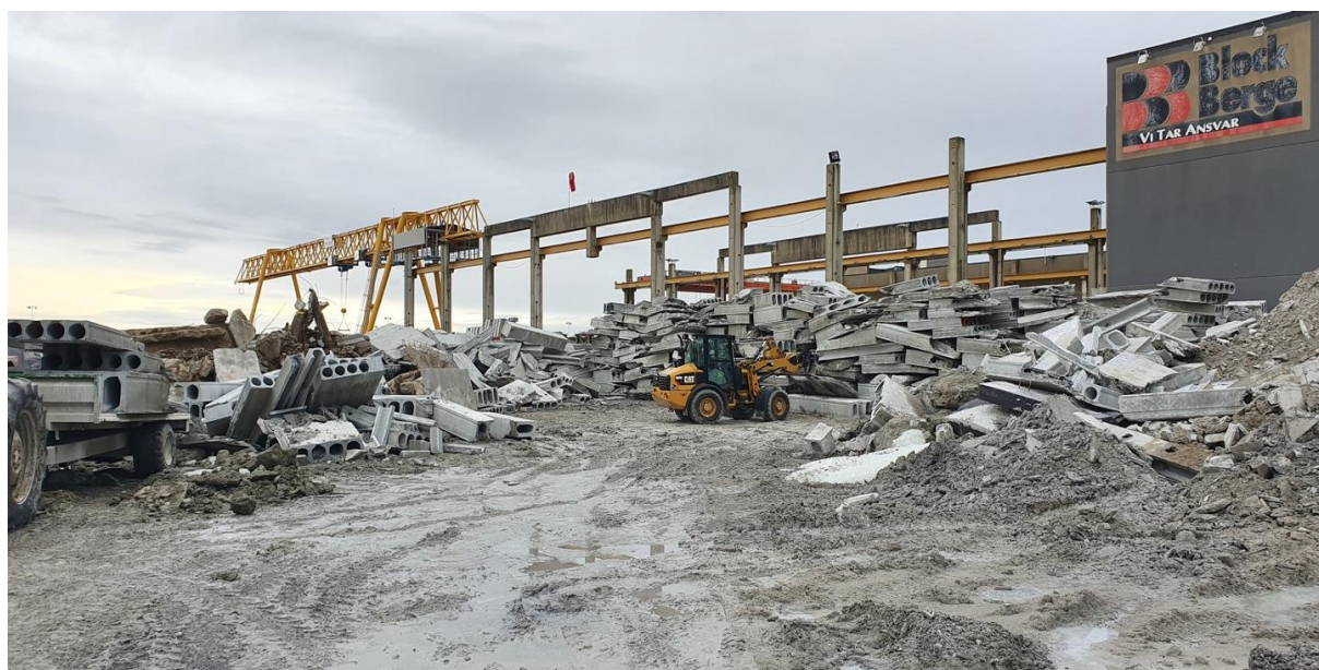
Bilde 1 Hulldekkeskalker i BBB
