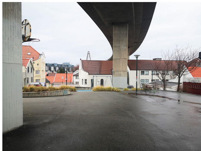
Foto 17 - Ei udefinert flate dekket i asfalt.
