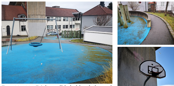
Foto 20 - 22 - Dårlig vedlikehald av leikeareal.
