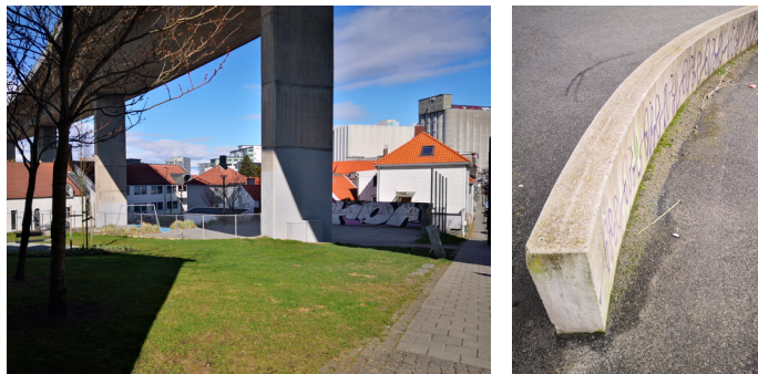
Foto 20 - 22 - Dårlig vedlikehald av leikeareal.
