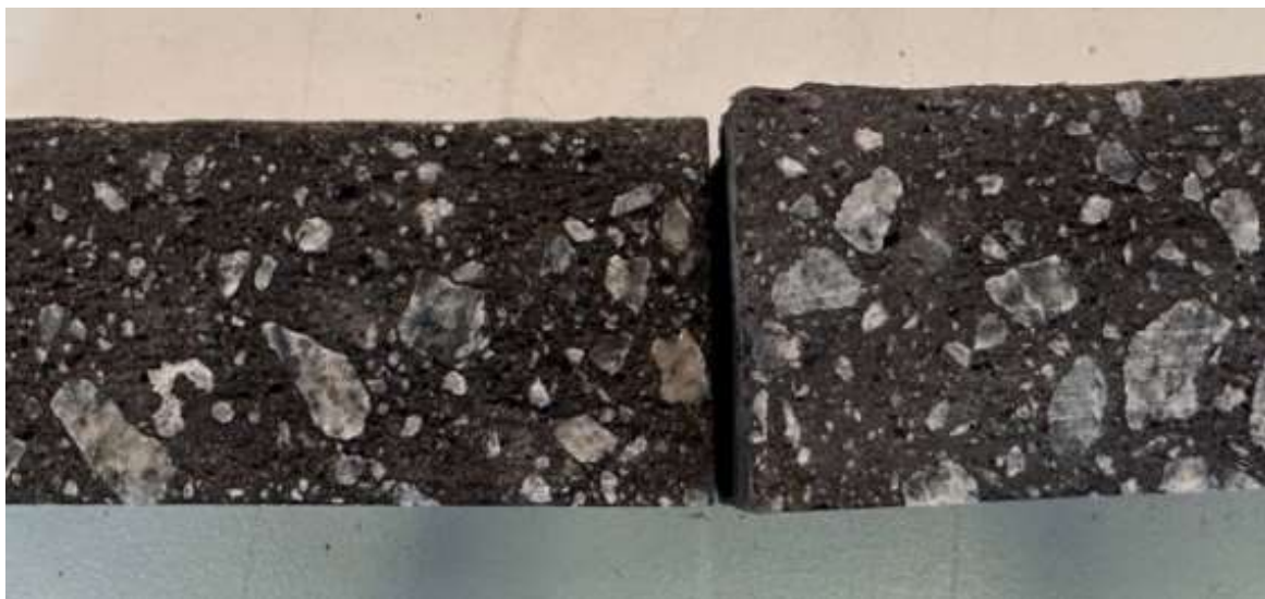
Figur 19 Prøvestykke etter kapping, som viser en ru og ujevn overflate.
