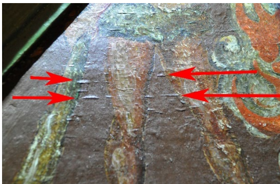
Figur 19 Detaljfoto av takformede oppskallinger på høyre gavlfelt. Fotoet er tatt med streiflys.
