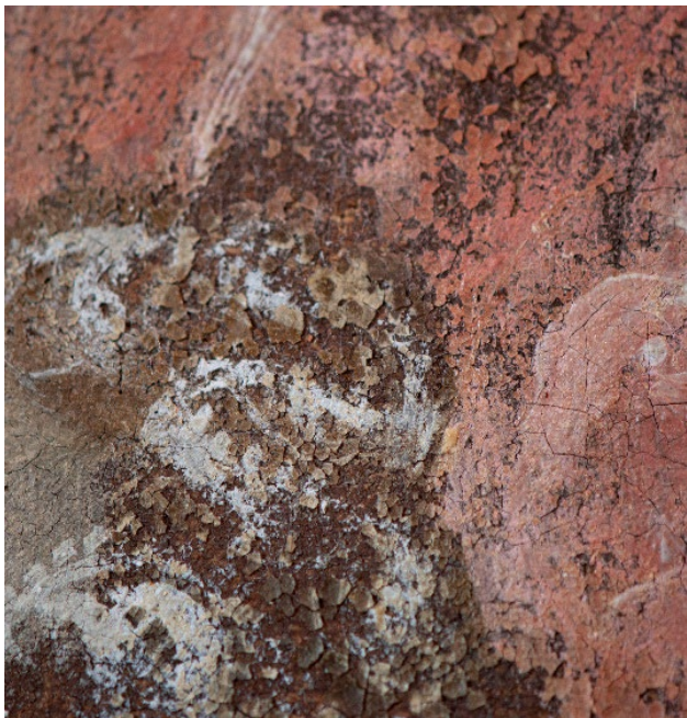
Figur 18) Klistrerester på overflaten som har ført til opp- og avskallinger
