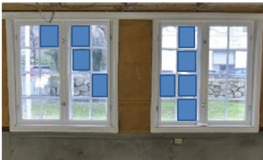
Fig. 40. 9 av glassene i vinduene skiller seg ut ved å være «ruglete».
