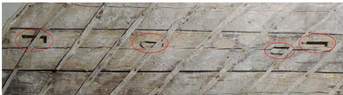
Fig. 30. Puss fjernet på vestveggenes brystning pga skade. Innhugg i tømmer (merket med rødt) etter «noe» - festepunkt for en tidligere brystning?
