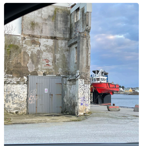
Figur 6.19: Konstruksjon på planområdet i svært dårlig tilstand (Foto: Thuestad, 2024).
