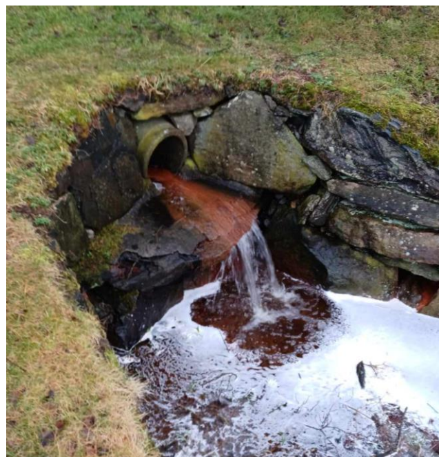
Figur 1.1: Tydelig skum og utfelt jern ved et av innløpene til Golfbanebekken 18.02.24.
