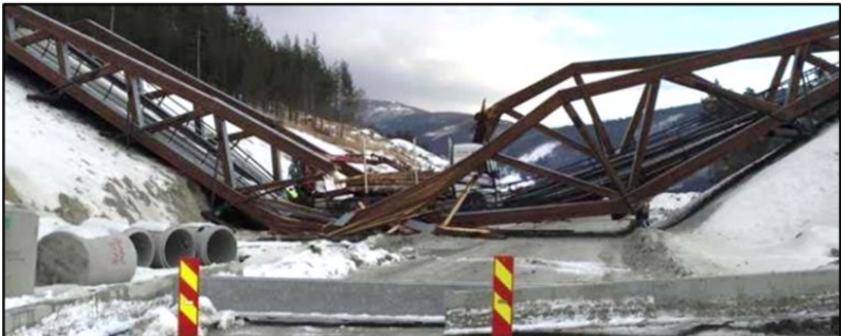
Figur 2 78 - Prosjekteringsfeil på bru medførte brukollaps
