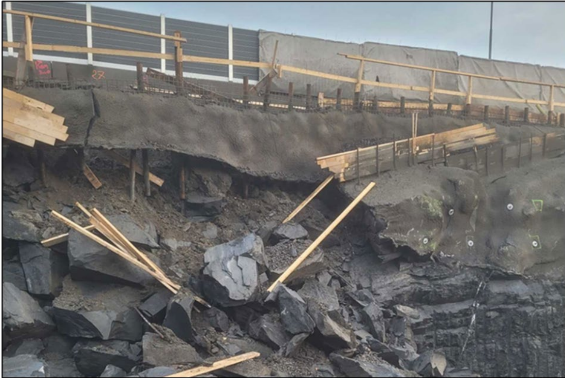
Figur3 81 - Bilde viser anleggsområde hvor grunnen har rast ut, noe som kan gi ringvirkninger for entreprenøren slik at retten til vederlagstillegg for «plunder og heft» inntreer. Foto: Statens vegvesen
